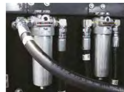
Sistema hidráulico protegido
